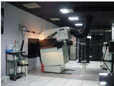
Un projecteur (derrière on aperçoit les armoires du son)
